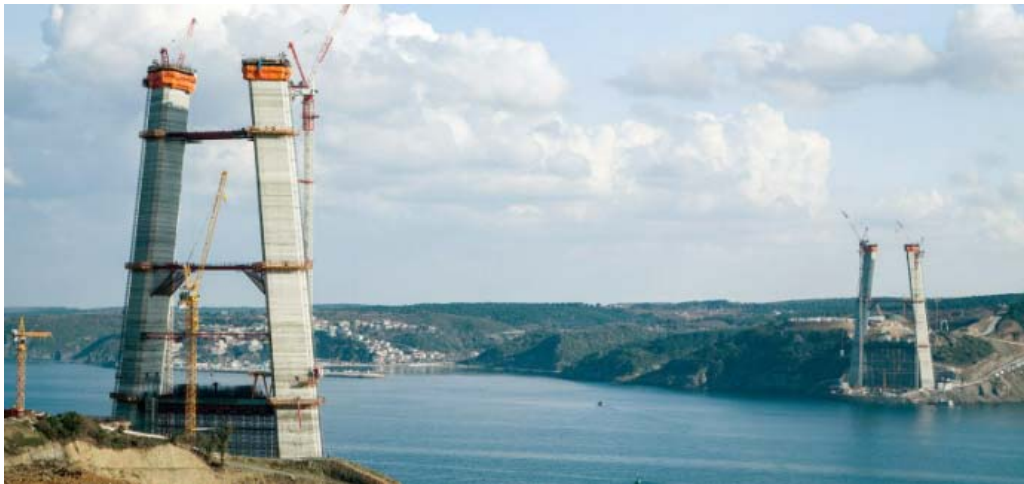
Figura 10 – Il terzo ponte sul Bosforo in costruzione, vista dal lato Europa. Si riconosce la presenza di 4 impianti slipform, uno per ciascuna torre
