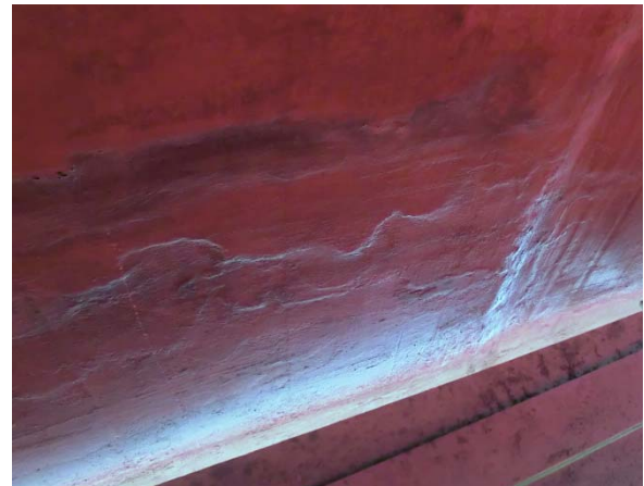
Figura 6 - Colature e rigonfiamenti dovuti a calcestruzzo semifluido (al di sotto del bordo inferiore della slipform)
